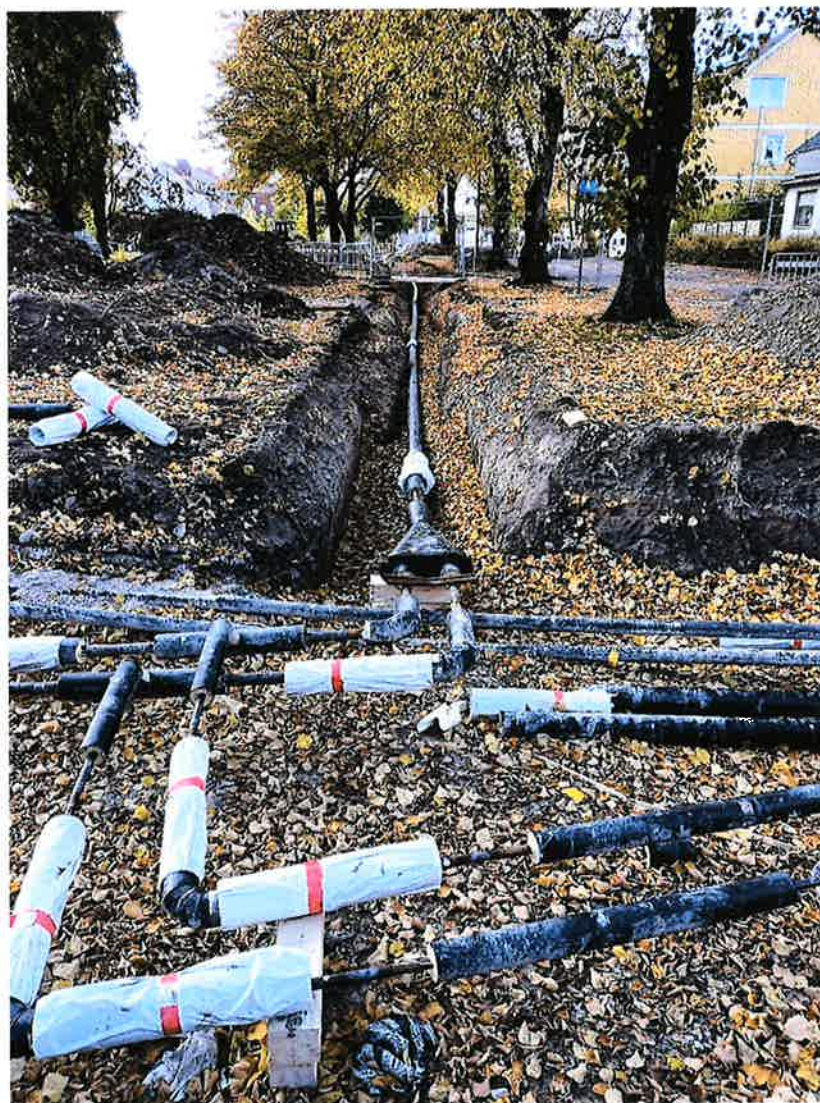
Utbyggnad kulvernät Mellerud
